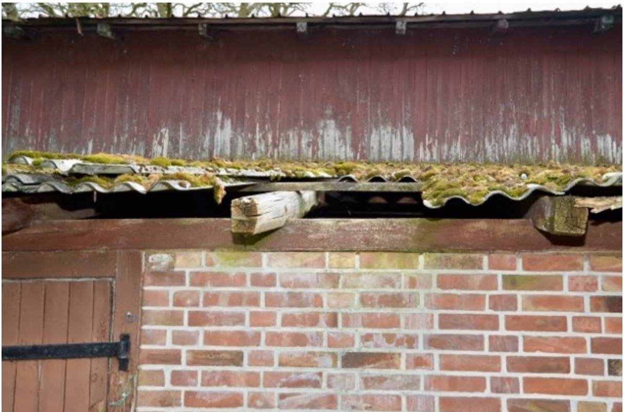
Foto 22 Schäden an Dach und Fassade des Maschinenschuppen und der Scheune (Pos. 3)
