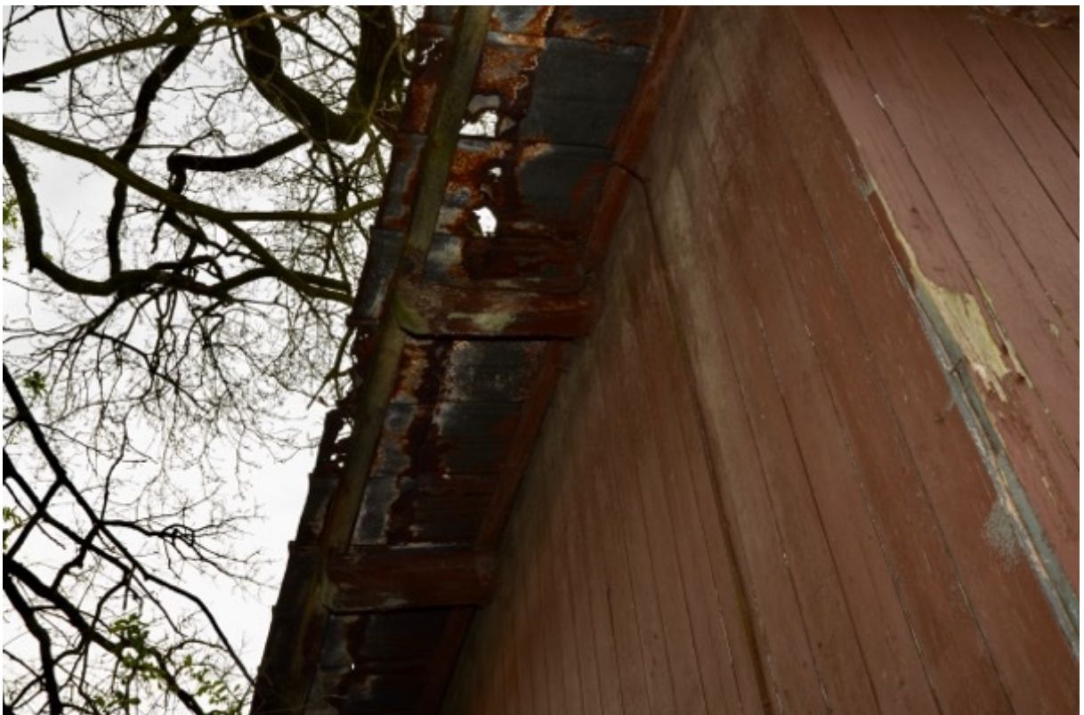
Foto 24 Schäden an Dach- und Wand an östlicher Traufe der ehem. Scheune (Position 3)
