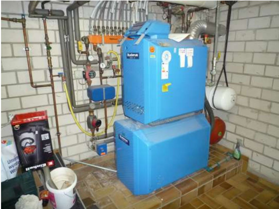
Heizung im Kellerraum 3
