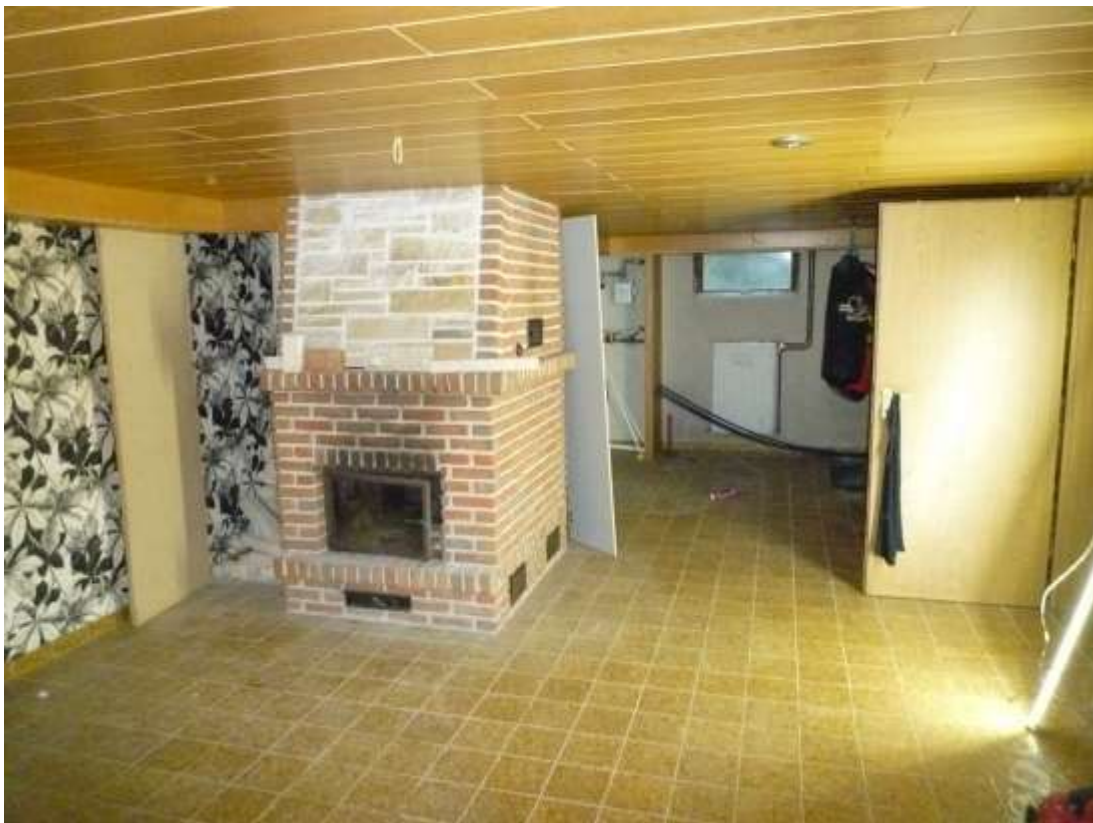
Kellerraum 4 / gemauerter Kamin (nicht genehmigt lt. Miteigentümer)
