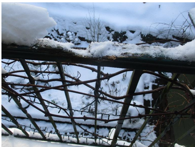
Handlauf Balkon abgängig
