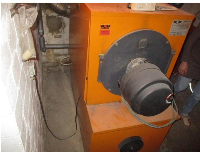
Heizungsanlage im Keller
