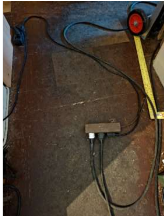
Abgenutzter Bodenbelag im Wohnbereich und Mehrfachsteckdose mit Verlängerungskabeln zu notdürftigen Stromversorgung
