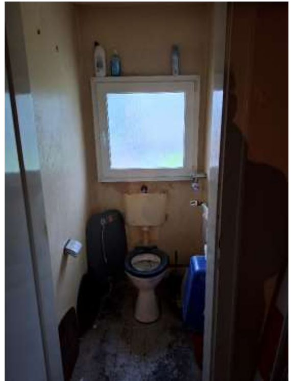
WC im Ausstattungszustand von 1962. Die Wände sind gestrichen. Der Fußboden ist mit stark verschmutzten Mosaikfliesen versehen. Ein Waschbecken ist nicht vorhanden.
