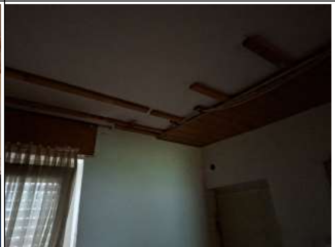
Unvollständige Deckenvertäfelung im Schlafzimmer
