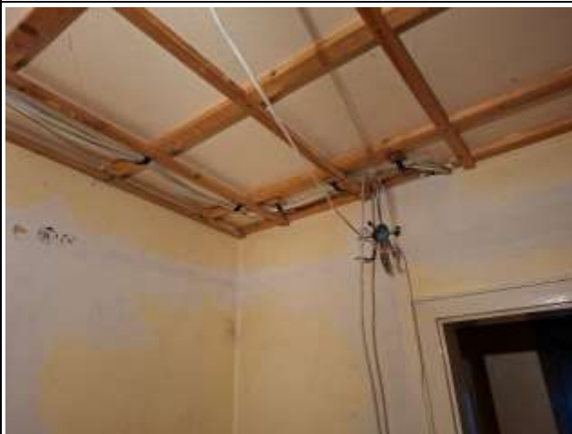
Provisorisch verlegte Deckenkabel in der „Küche“
