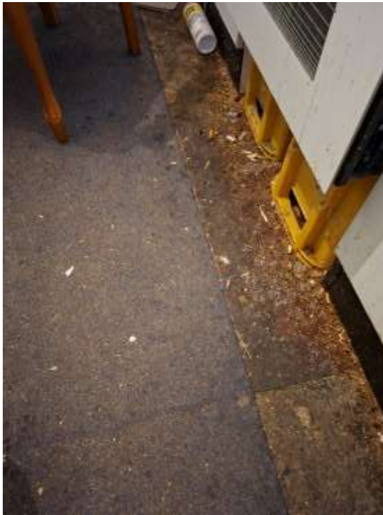
Abgenutzte Teppichfliesen von 1962 im Essbereich
