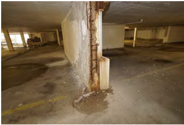
Bild Nr.: 7 Tiefgarage mit Bauschäden
