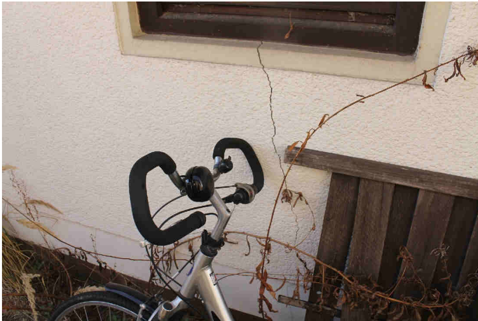
Riss in Außenwand
