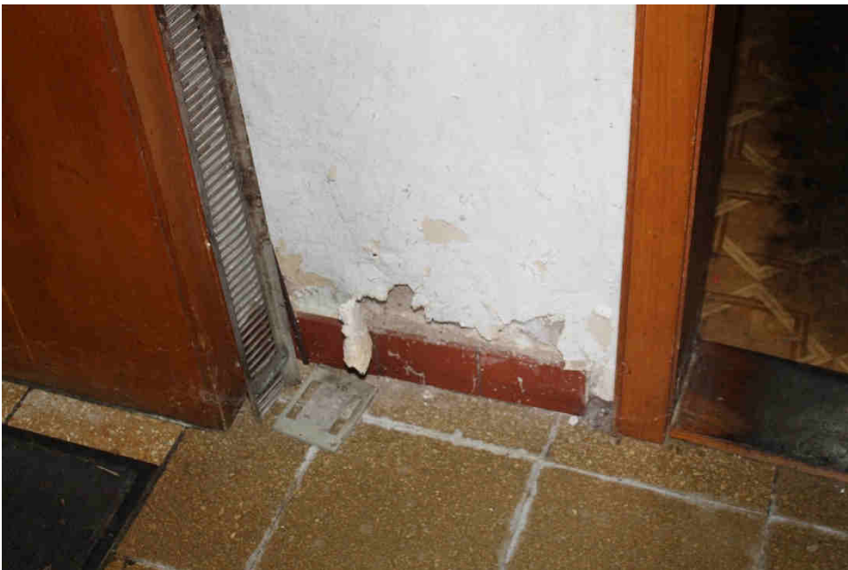
Feuchtmerkmale im Erdgeschoss
