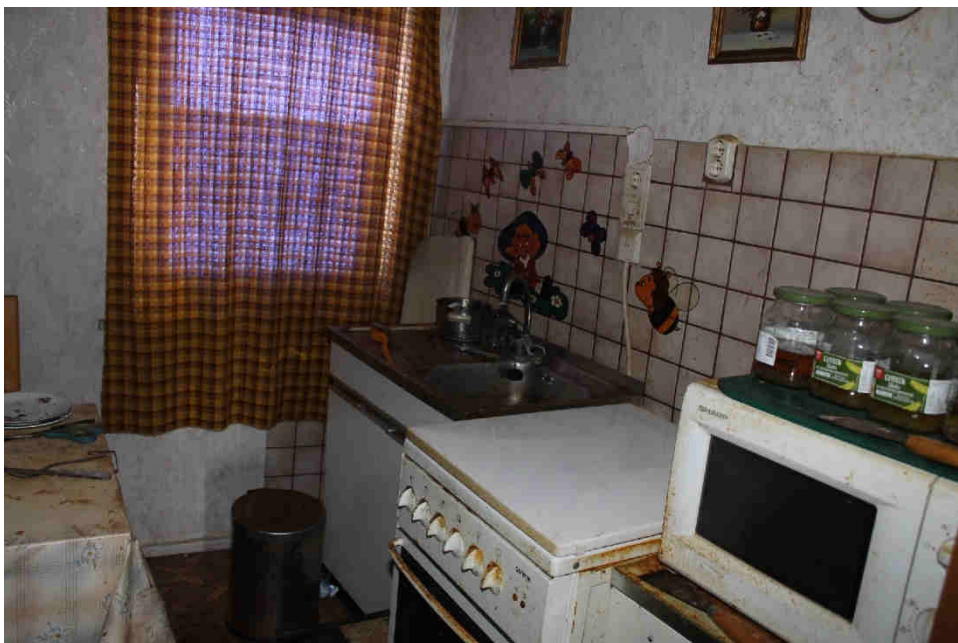
Küche im Erdgeschoss (Exemplarischer Zustand des Gebäudes)
