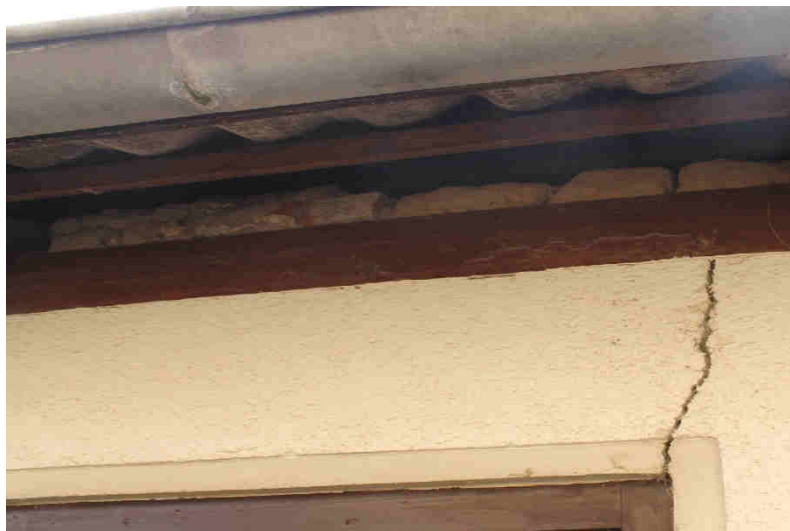
Riss in Außenwand
