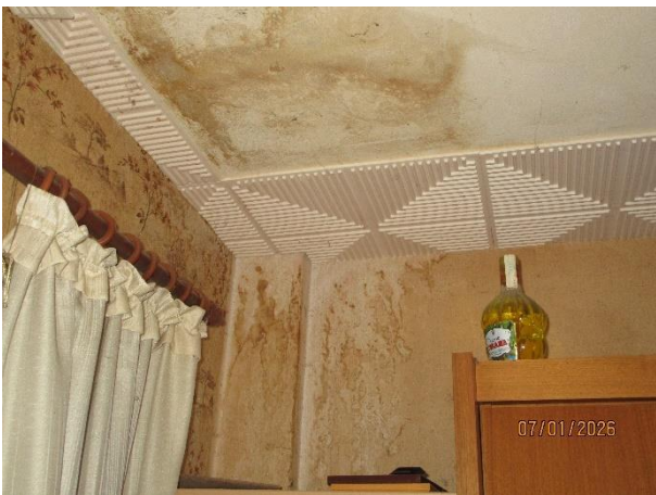
Wasserschaden EG (alt)
