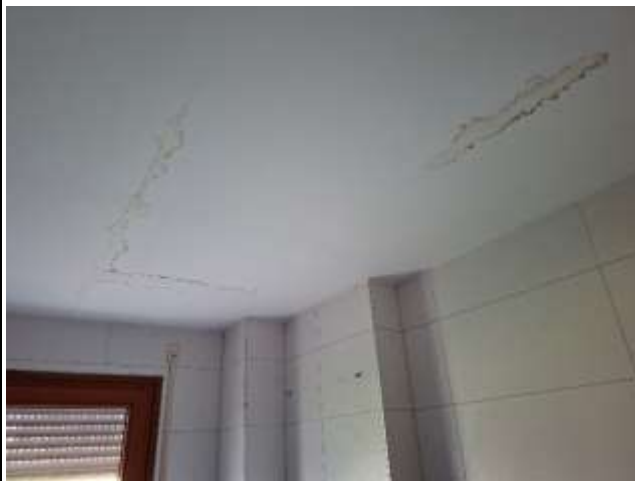
Bad EG: Wasserflecken an der Decke aufgrund eines Wasserschadens in der Dusche Bad DG
