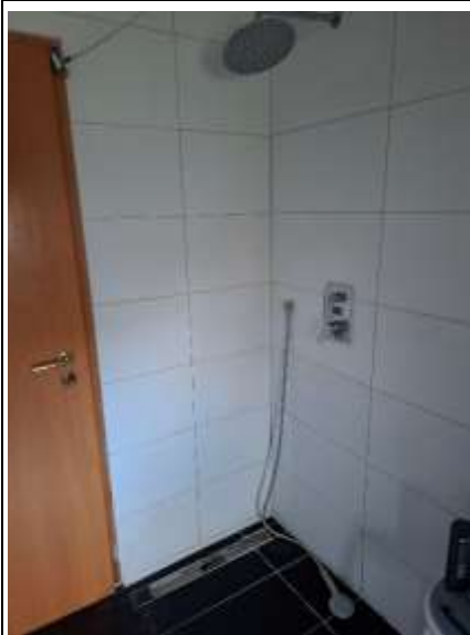
Bad EG: bodengleiche Dusche mit fehlender Dusch- abtrennung
