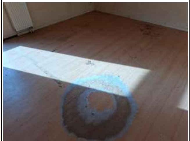
Abgenutzter Laminatfußboden im Zimmer 2 des Dachgeschosses
