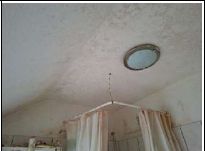
Stockflecken an Decke und Wand des Bades und Schimmelpilzbefall im Duschbereich
