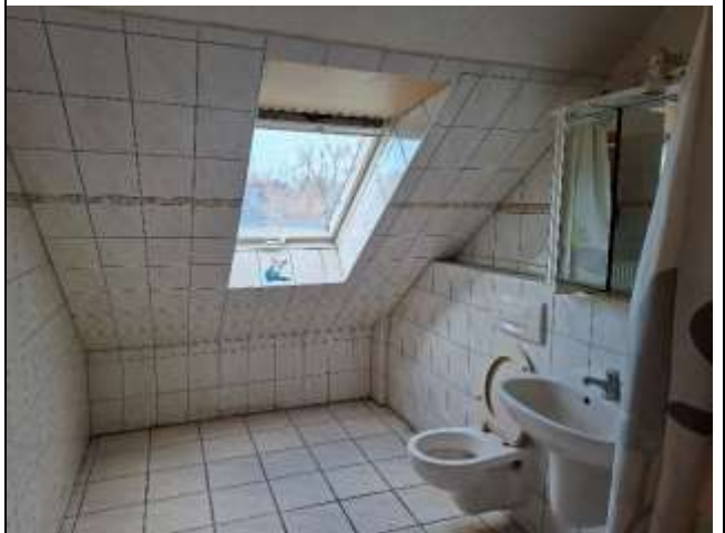
Bad DG mit Wasserschaden in der Dusche
