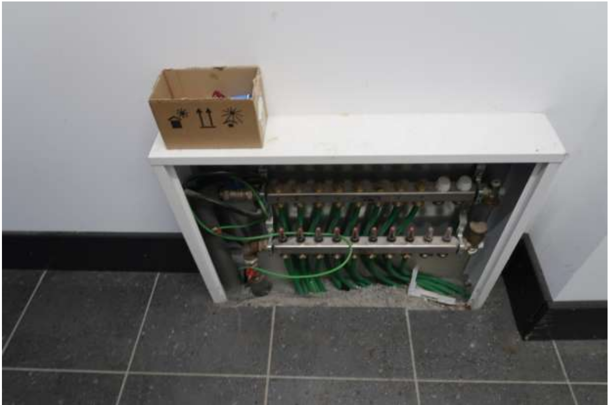
- Erdgeschoss Flur mit Fußbodenheizungsverteilung -
