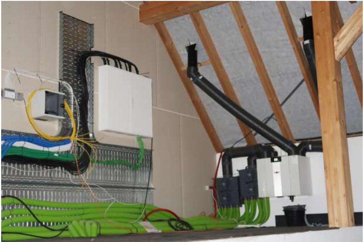
- Dachgeschoss kontrollierte Lüftungsanlage -
