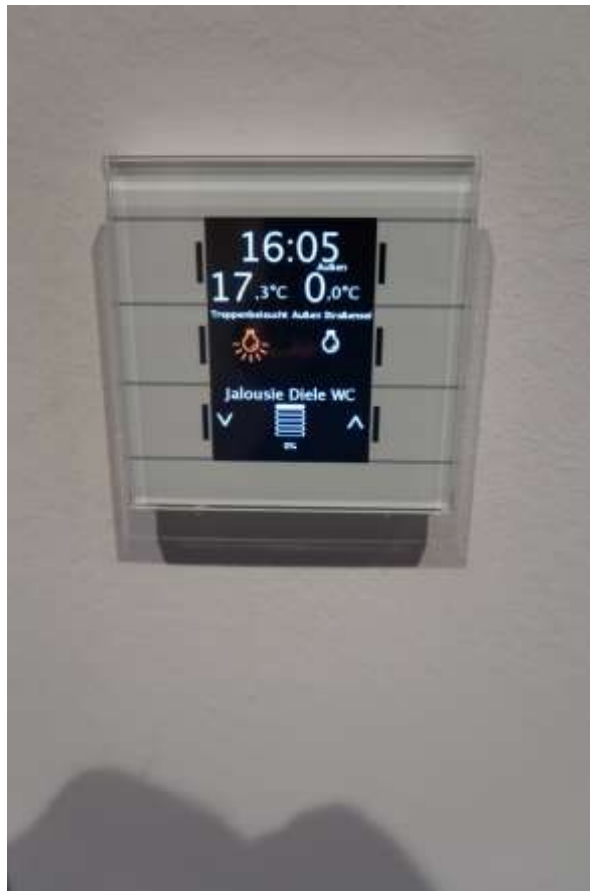
- Erdgeschoss Bussystem Schalter -
