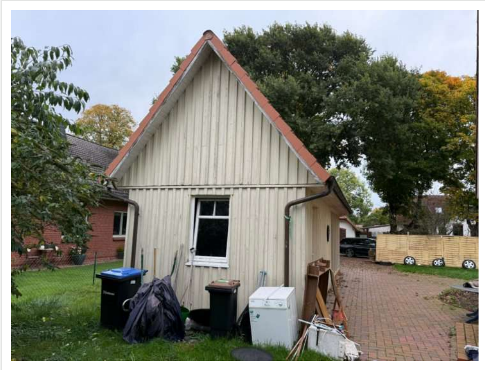
r. Zustand Carport- Gerätekammer
