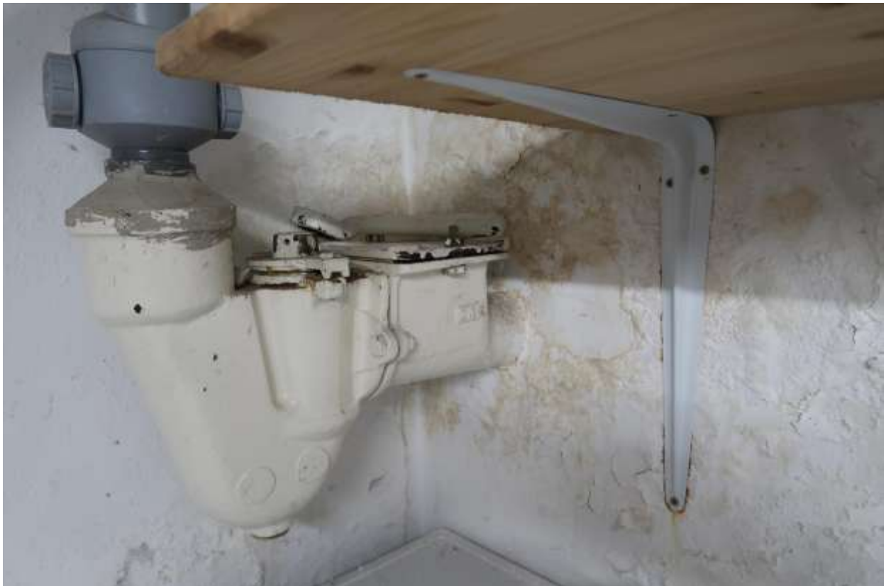
- Kellergeschoss Feuchtigkeitsschaden an der Wand sichtbar -
