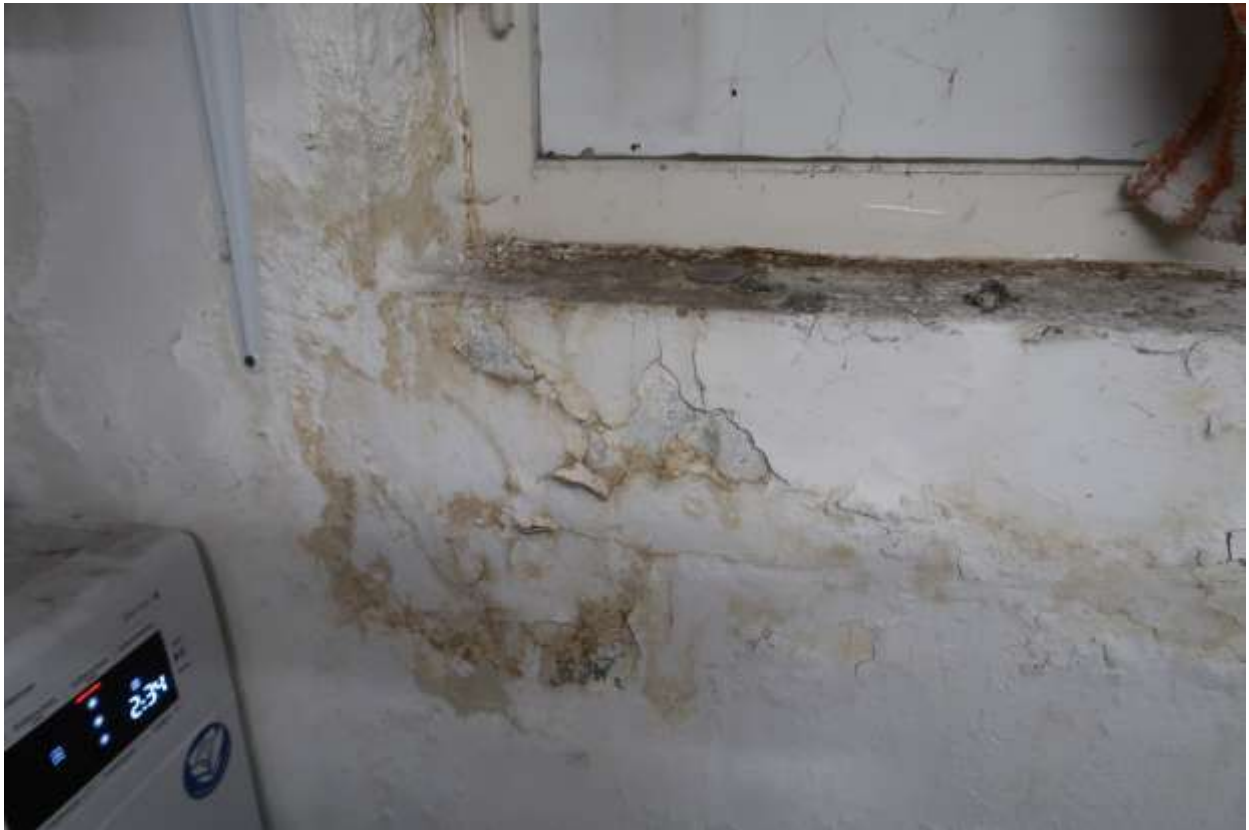
- Kellergeschoss Feuchtigkeitsschaden an der Wand sichtbar -
