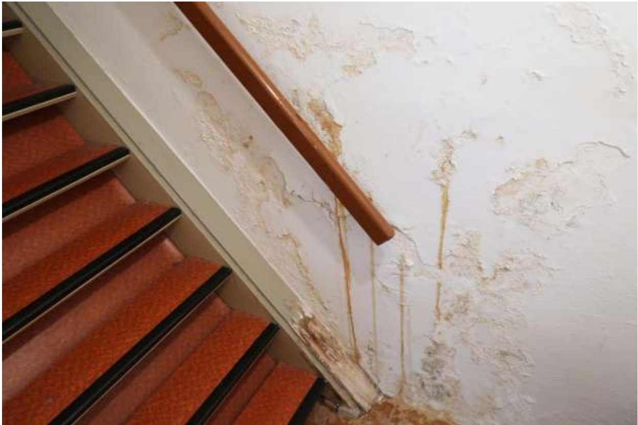
- Kellergeschoss Feuchtigkeitsschaden an der Wand sichtbar -
