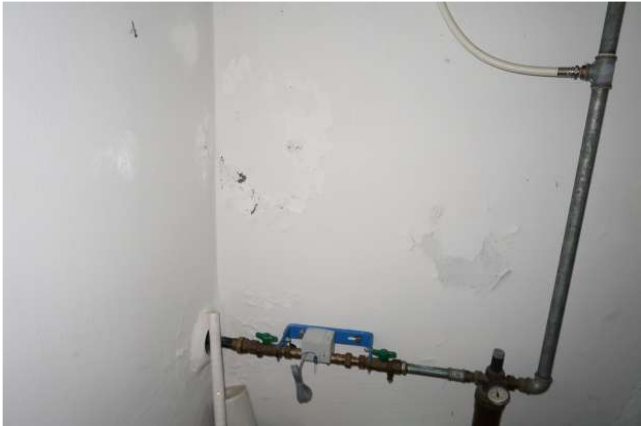
- Kellergeschoss Feuchtigkeitsflecken an der Wand sichtbar -
