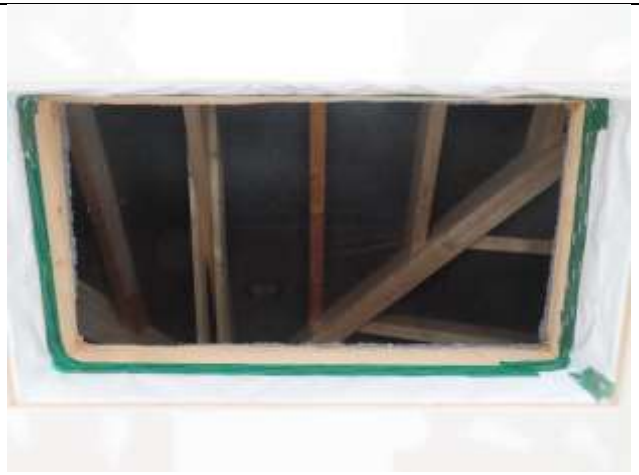
Blick ins DG / Einschubtreppe fehlt
