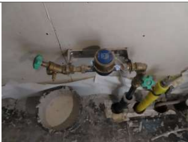
Hausanschlüsse Gas und Wasser
