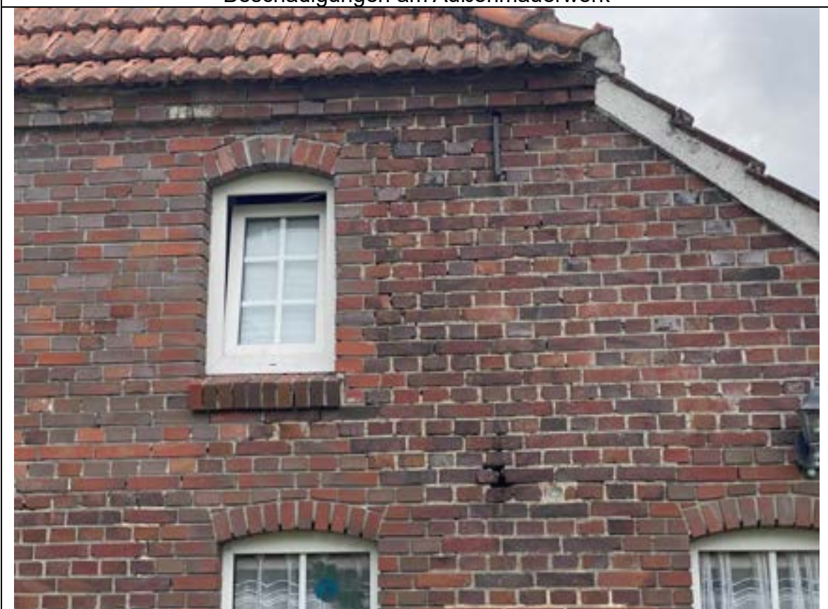
Beschädigungen am Außenmauerwerk
