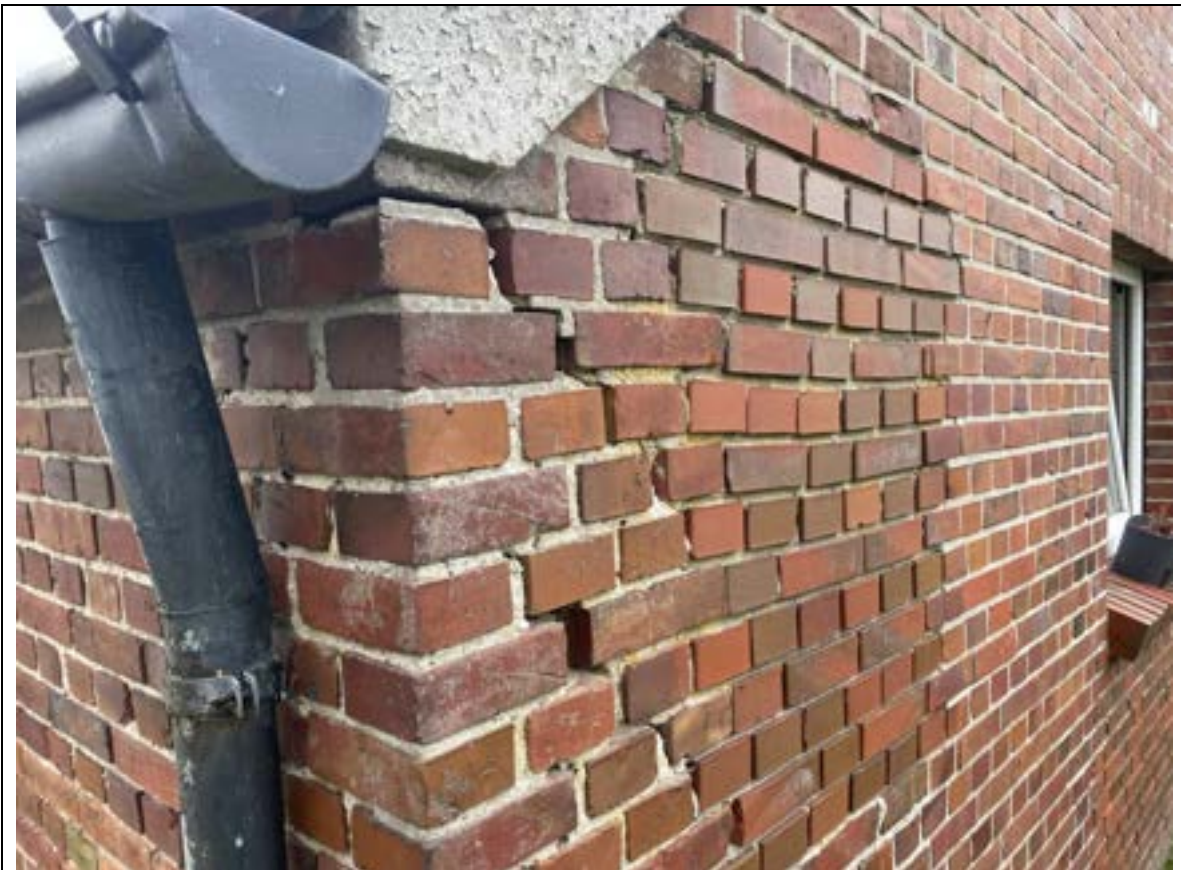
Beschädigungen am Außenmauerwerk
