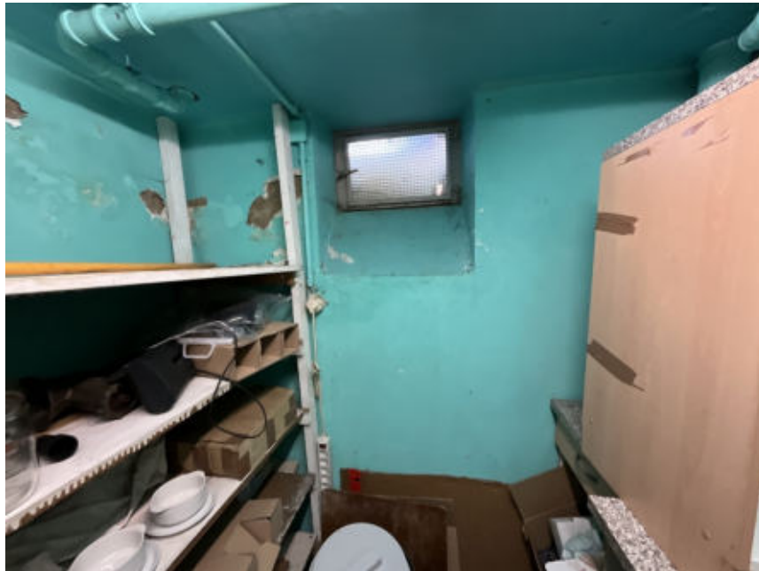
Kellerraum mit Feuchtigkeitsschäden
