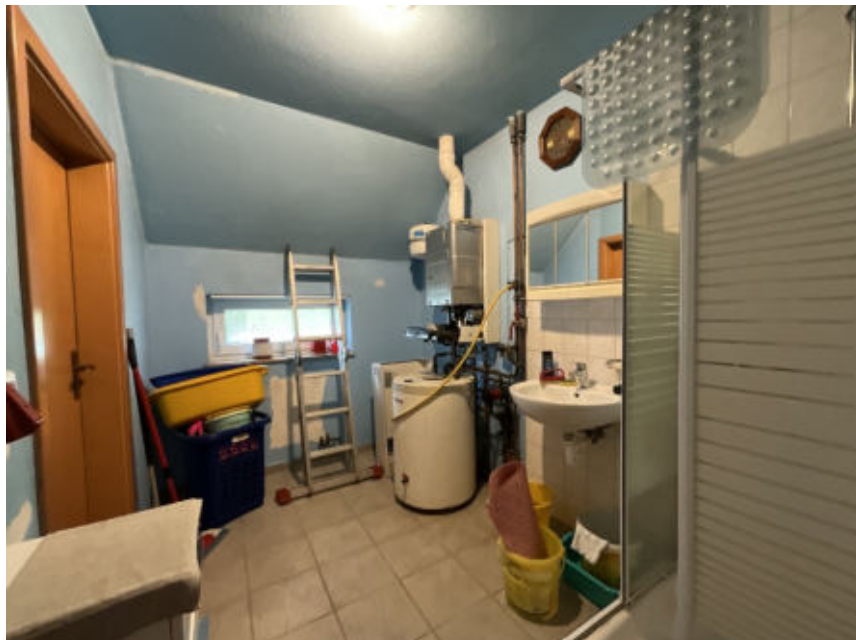
Hauswirtschaftsraum mit Heizung
