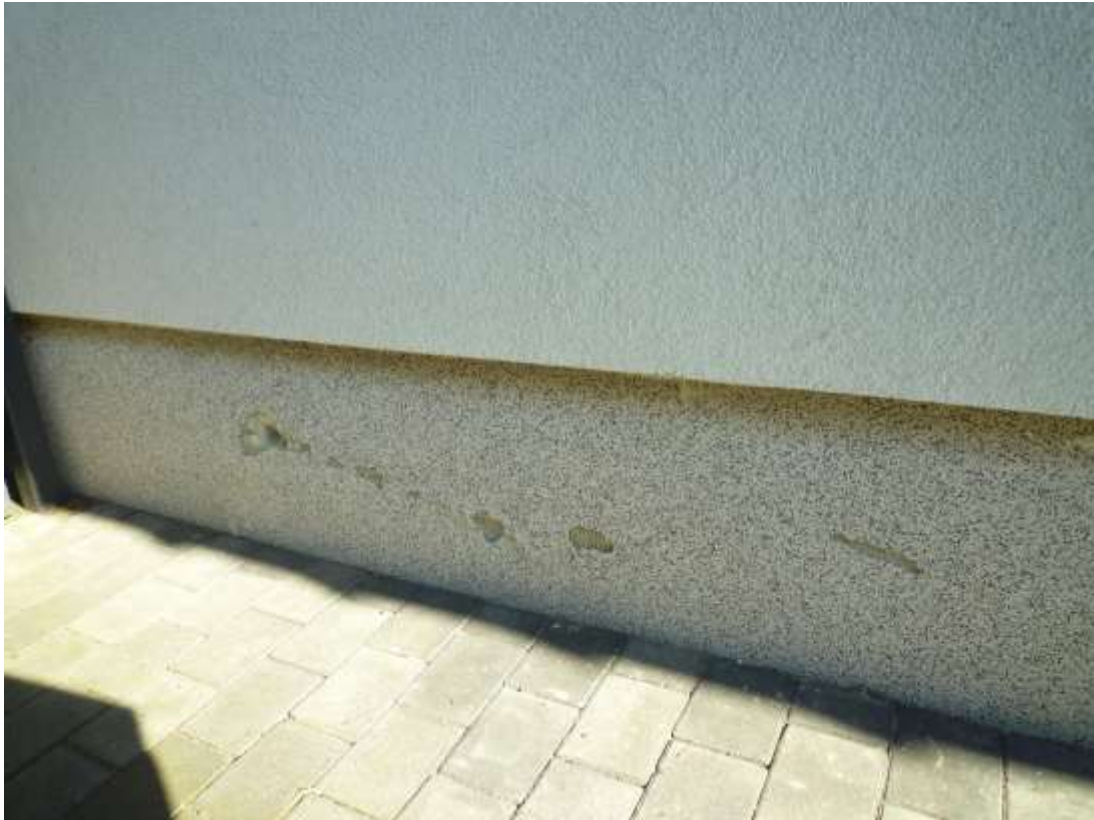
Schäden am Wärmedämmverbundsystem (Beispiel)
