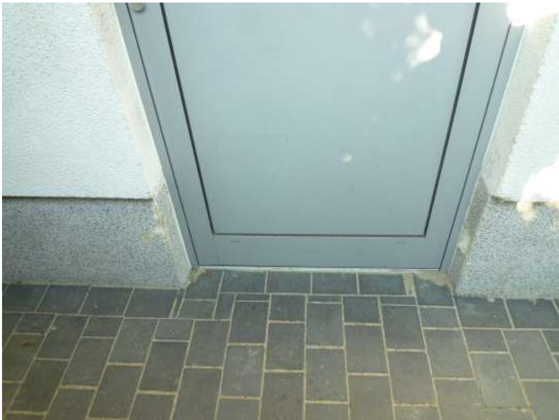
Schäden am Wärmedämmverbundsystem (Beispiel)
