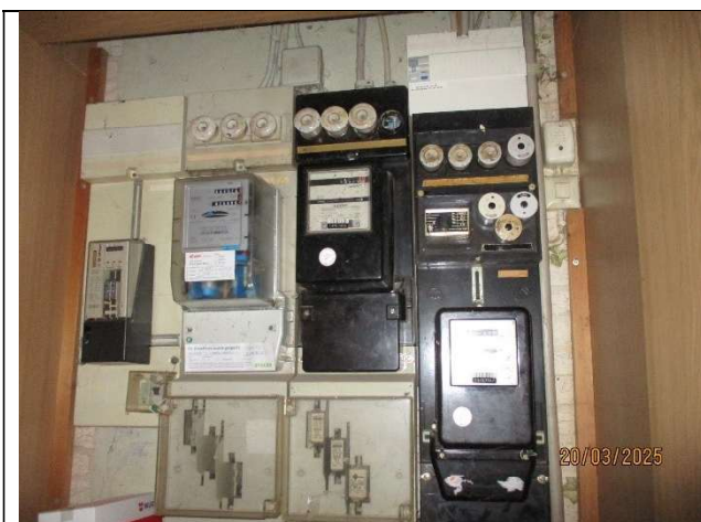
Sicherungskasten (EG rechts)
