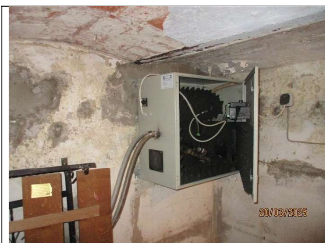
Elektrik für Kleinkläranlage im Keller
